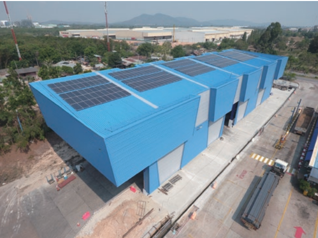
Siam Yamato Steel Co., Ltd.(SYS)で導入している太陽光発電設備
